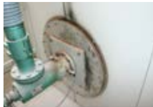
pakking als afdichting brander. Eventueel meerdere pakkingen toegepast
