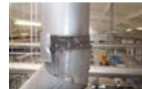
Asbest pakking in gasafvoerkanaal
