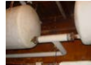
isolatie leidingen en vaten verwarming- of stoominstallatie
