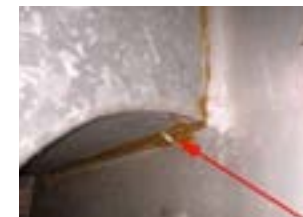
kitafdichting bij metalen luchtkanaal
