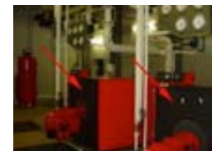
ketel die asbesthoudende onderdelen kan bevatten. De fundering van de ketel kan ook asbesthoudende beplating bevatten
