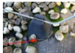
bitumen onder afstandhouder bliksemgeleiding
