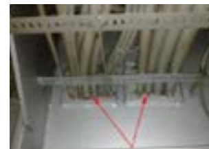
afdichting bij kabeldoorvoer
