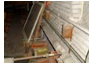
isolatie leidingen en vaten verwarming- of stoominstallatie
