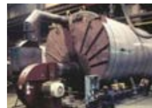
isolatie en afstandhouders in ketel en boilers
