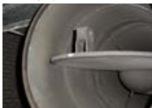
brandklep in (luchtbehandelings)kanalen
