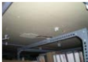
cementplaat met cellulosevezels als plafondplaat toegepast. Zacht materiaal
